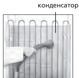
Рисунок 9 — Уборка холодильника (вид сзади)
